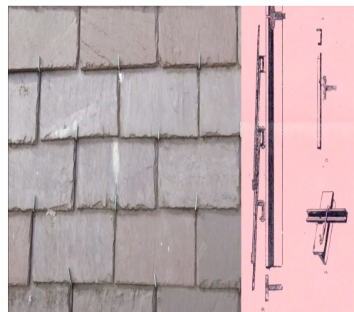
Restaurer c'est aussi innover : l'exemple de la création des crochets pour faire tenir les ardoises sur la toiture.
